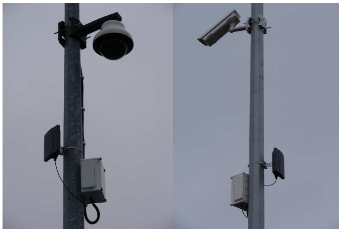
Instalacja systemu monitoringu dla firmy Cersanit w Wałbrzychu
