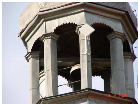
Instalacja na wieży kościoła w Radzowicach
